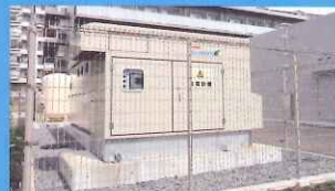
自家発電設備
