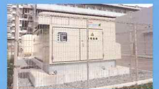
自家発電設備
